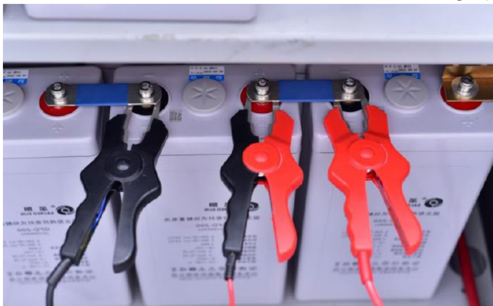
Рис. 3.1.2.2 Пример закрепления зажимов на аккумуляторной батарее
